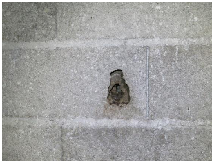
Photo 8 : Cavités dans la structure
