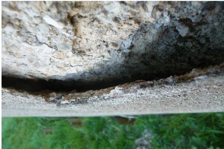
Photo 5 : Décollement de crépis
