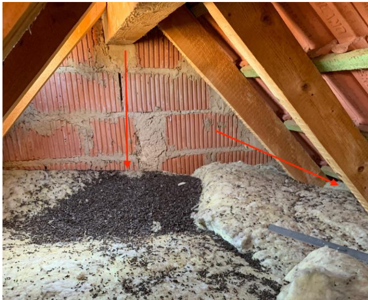
Photo 11 : Espace entre isolation et toiture
