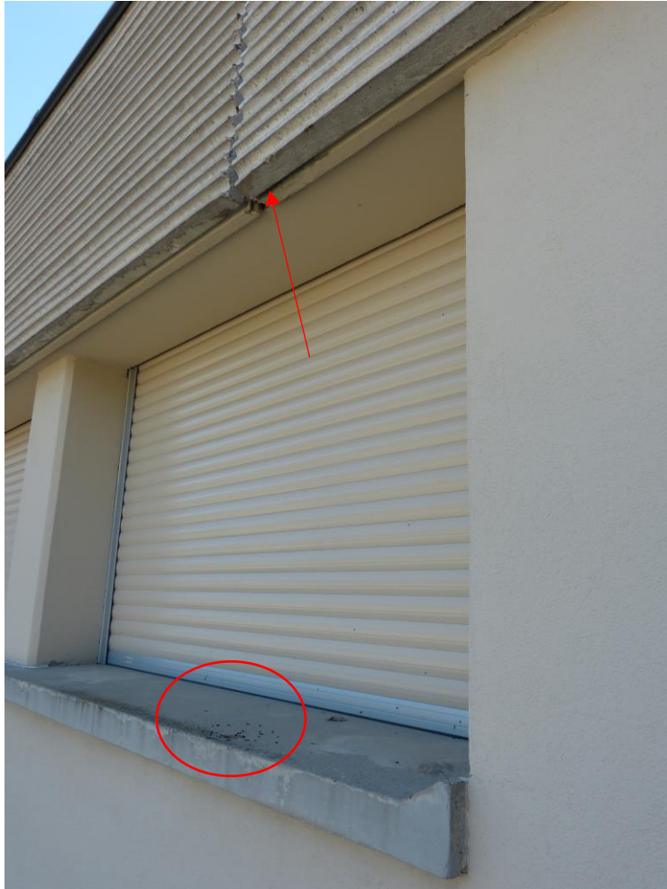
Photo 24 : Disjointement entre mur et encorbellement
