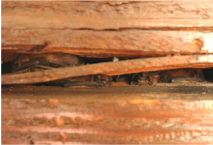
Photo 9 : Cavités dans du bois
