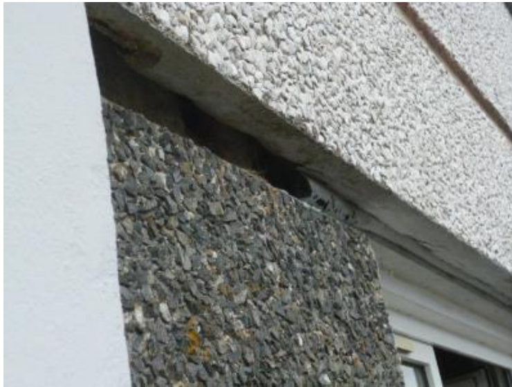
Photo 18 : Espacement entre les éléments béton
