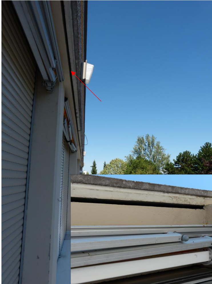
Photo 22 : Disjointement au-dessus d'une fenêtre
